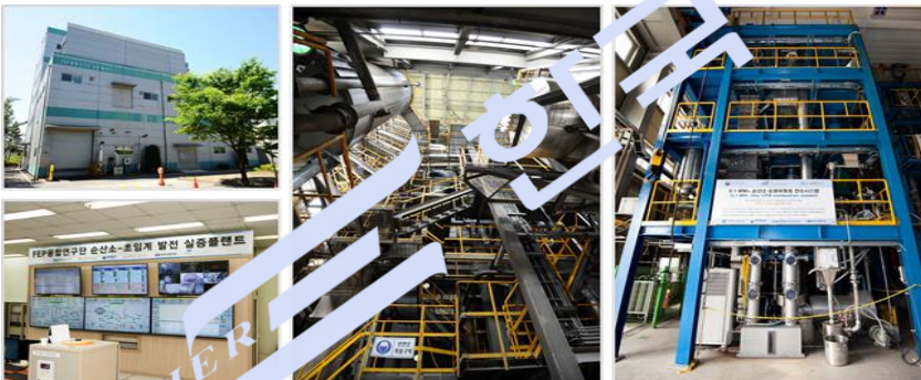
[순산소 순환유동층 연소 실증 플랜트(10 MWth/100 kWth)]
