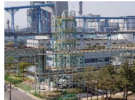
[태안 0.5MW 습식 포집 실증 설비] (19년 준공, 다용도 Test bed로 활용 중)
